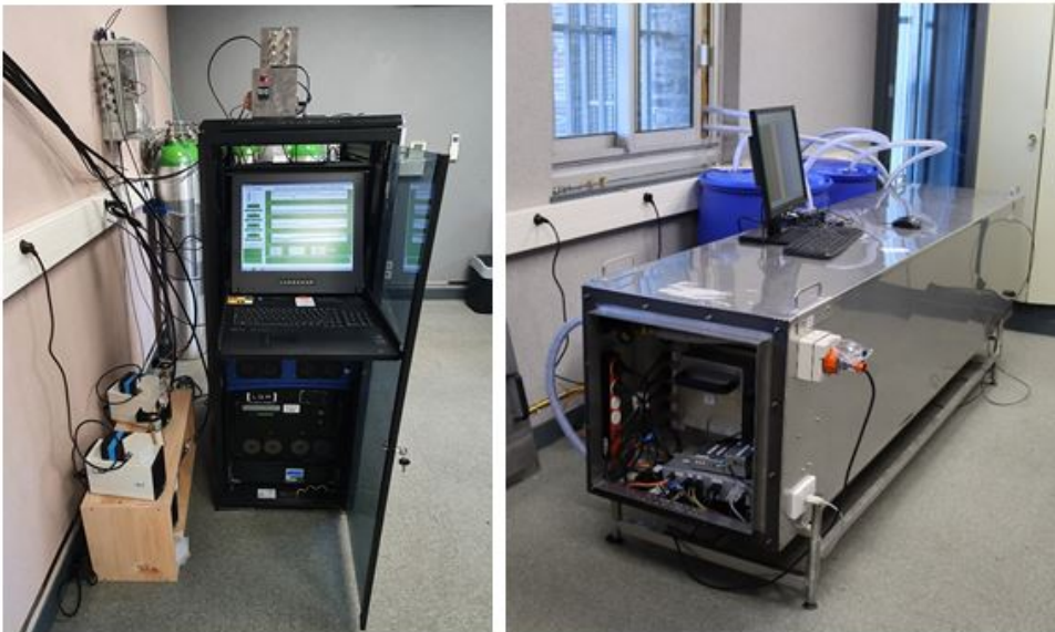
Figure 3: Analyseurs installés au pied de l'émetteur de TDF à Roc'h Tredudon
